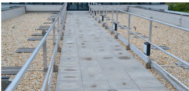
Abb. 9: Seitenschutzsysteme und Geländer zur Sicherung von Personen in absturzgefährdeten Bereichen nach DIN EN 13374
