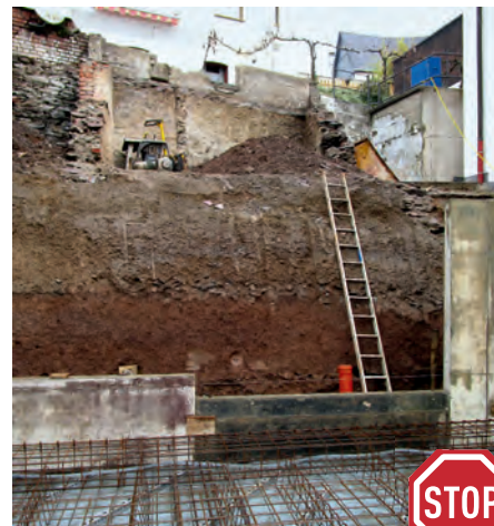
Abb. 5: Auch hier wurde eine zu kurze Leiter gewählt und zudem die Baugrube nicht gesichert (Quelle: BG BAU, J. Maringer)
