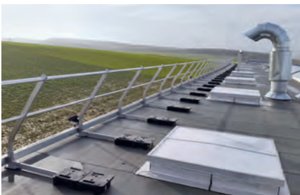
Abb. 6a und b: Mobile Umwerrungssysteme können nachgerüstet werden. Zusammen mit gegen Durchsturz gesicherten Lichtkuppeln und Zugängen erlauben sie ein sicheres Arbeiten auf dem Dach (Foto: ETANCO GmbH)
