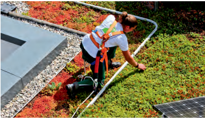
Abb. 9: Wenn technische Maßnahmen wie Umwahrungen nicht möglich sind, ermöglichen z.B. dauerhaft installierte Schienensysteme ein sicheres und wirtschaftliches Arbeiten (Foto: Zinco)
