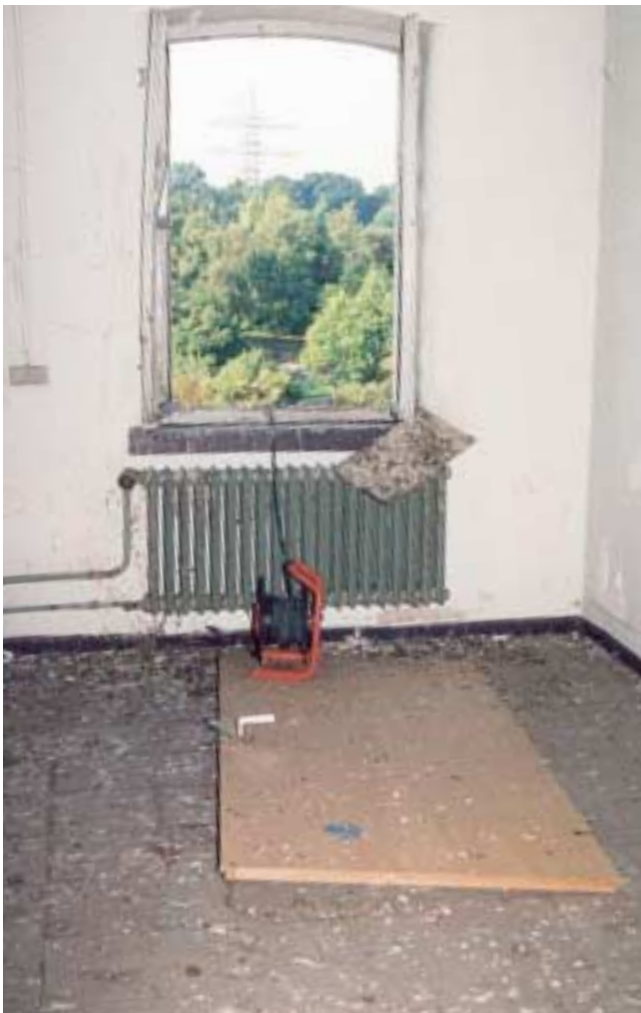
Abb. 3a, b: Taubenkotkontamination, die gut absaugbar ist
