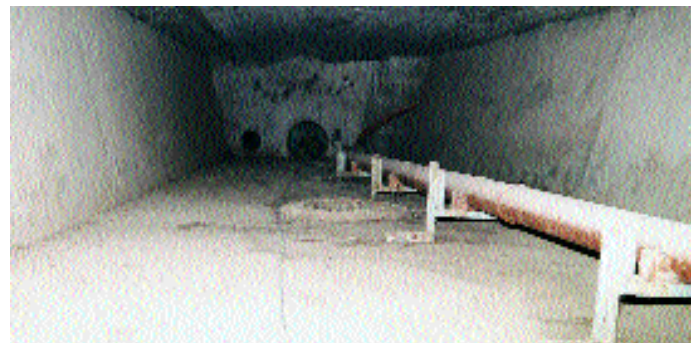
Abb. 7: Von Taubenkot gereinigter Raum unterhalb einer Brücke in Ludwigshafen. Bis auf die runde Öffnung im Hintergrund (Durchmesser 60 cm) besteht keine Verbindung nach außen. Vor der Reinigung befanden sich einige dutzend Tauben, Gelege, Kadaver und Gerippe in der Räumlichkeit. Der Boden war flächendeckend etwa 10 cm hoch mit Taubenkot bedeckt. Das überwiegend getrocknete, z.T. auch frische Material wurde durch Schaufeln und Abfüllen in Kunststoffsäcke unter starker Staubproduktion entfernt
