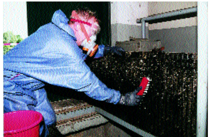
Abb. 11: Reinigung eines durch Taubenkot verunreinigten Treppengitters durch feuchtes Abbürsten
