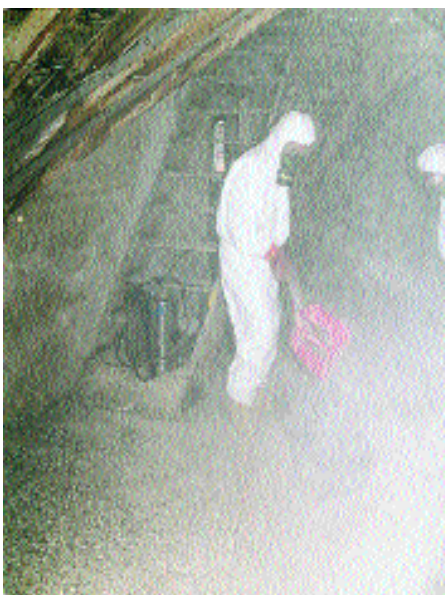
Abb. 9: Ein mit Taubenkot verunreinigter Dachboden in Koblenz. Der Fußboden war teilweise bis zu 1–2 cm Höhe mit überwiegend trockenem Taubenkot bedeckt. Vor Beginn der Reinigung befanden sich einzelne Tauben in den Räumlichkeiten. Auf dem Bild ist eine typische Reinigungstätigkeit zu sehen, in dessen Verlauf sehr viel Staub in die Luft gelangte
