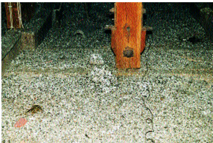
Abb. 1: Von Tauben genutzter Dachboden. Der Fußboden ist flächendeckend in einer Höhe von einigen Zentimetern mit Taubenkot belegt. Unter bevorzugten Sitzplätzen kommt es zu deutlich erheblicheren Anhäufungen. Vereinzelt sind Kadaver zu sehen (Fotos: A. Albrecht)
