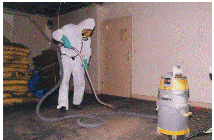
Abb. 14: Reinigungsstätigkeiten mit einem K1-Industriestaubsauger in einem mit Taubenkot verschmutztem Gebäude in Berlin. Tauben hatten seit etwa 1993/94 keinen Zugang mehr zu den Räumlichkeiten
