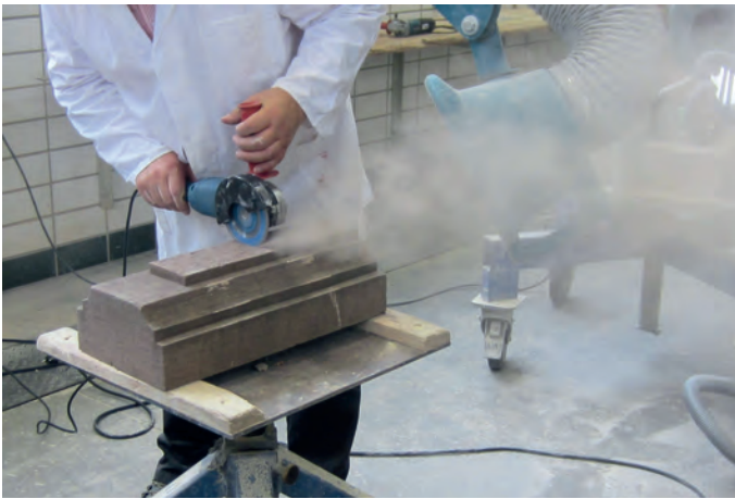
Abb. 1: Ziehender Schnitt am Werkstück ohne Absaugung direkt an der Handmaschine mit deutlicher Stauffreisetzung; die Absaugvorrichtung wurde mangelhaft nachgeführt, auf Baustellen ist diese ohnehin nicht vorhanden
