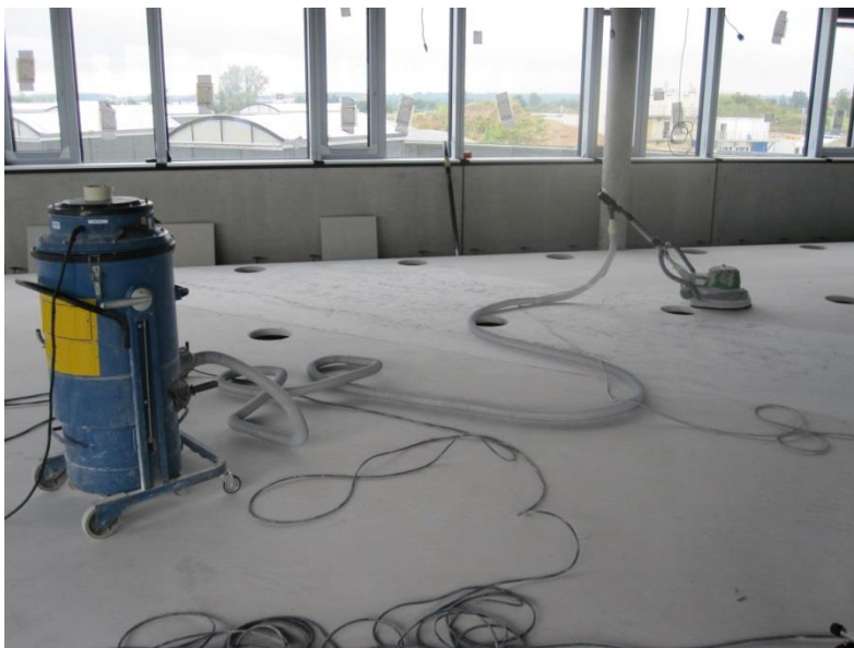
Bild 1: Absaugung von Bodenschleifmaschinen in einem Verwaltungsgebäude (Foto:BG BAU; Wiesenhütter)
