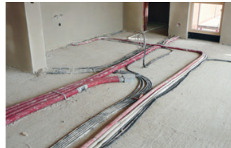
Rohrleitungen auf der Rohdecke
