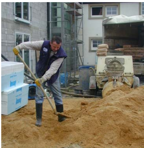
Abbildung 2.1: Estrichleger mit typischer Schaufelhandhabung beim Befüllen der Estrichmaschine: weite Distanz (oben), kurze Distanz (unten)
