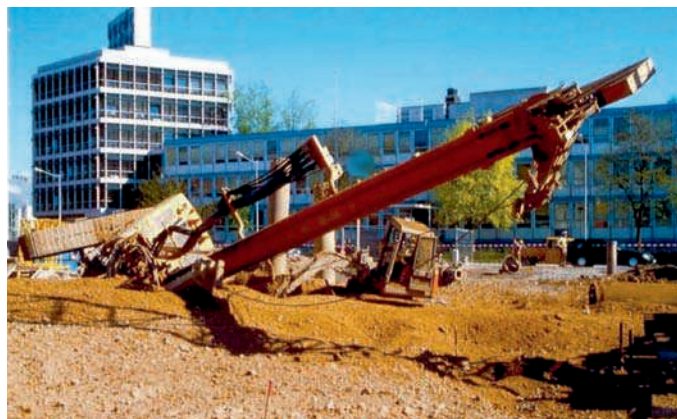
Abb. 2: Bei Bohrarbeiten 5-Zentner-Bombe angebohrt
