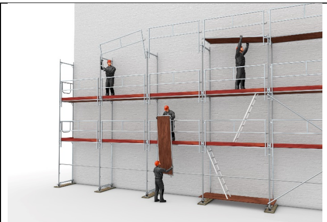
Systemimmanentes Seitenschutzbauteil, das bei Umbauarbeiten ausgebaut werden kann
