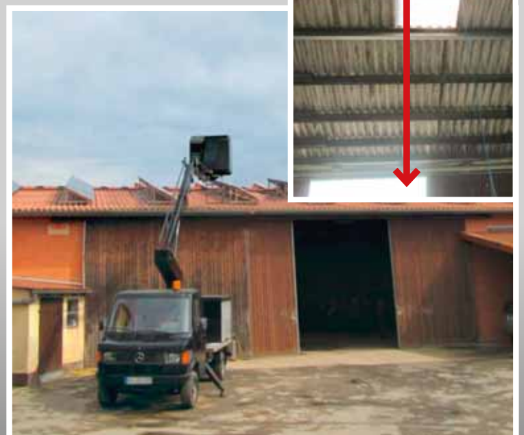
Trotz Warnung durch die Auftraggeber brach der Mitarbeiter einer Reinigungsfirma durch eine nicht begehbare Lichtplatte im Scheunendach.
