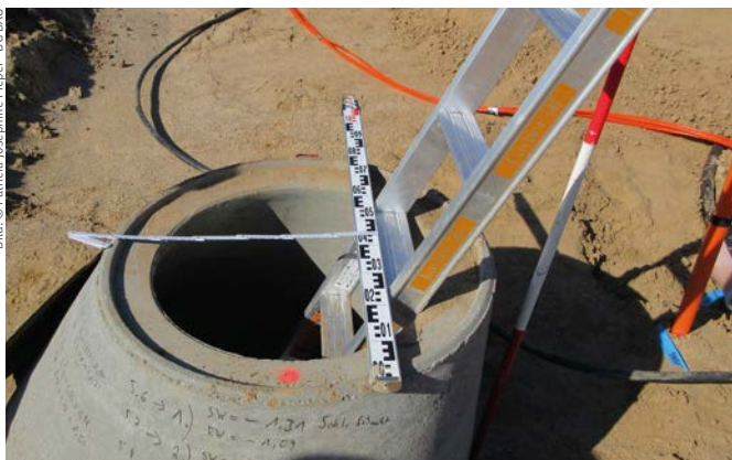
Verengter Querschnitt durch Stufenanlegeleiter in einem Abwasserschacht ohne Schachtabdeckung
