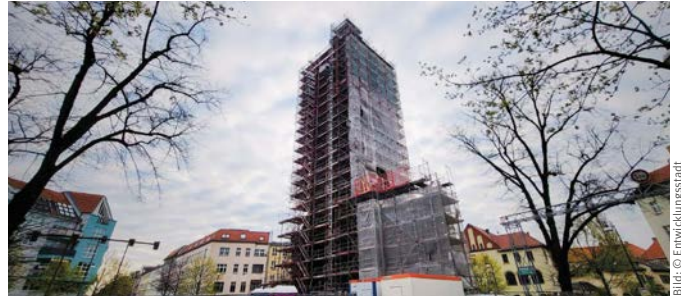
Auf dem Gelände der ehemaligen Bethanienkirche in Berlin-Weißensee entstehen 17 Wohnungen im Kirchturm und im angrenzenden Neubau.
