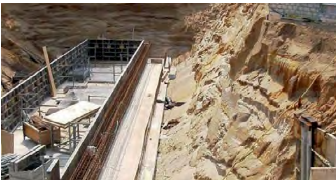
Baugruben aus gleichförmigem (sandigem) Boden können bei entsprechender Witterung und scheinbarer Kohäsion problematisch für die Standsicherheit sein – trotz Böschungswinkel >45^\circ .
