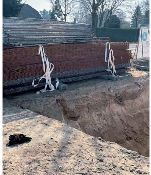
Lagerung von Bewehrungsmatten an einer unzureichend geböschten Baugrube (>45 Grad)
