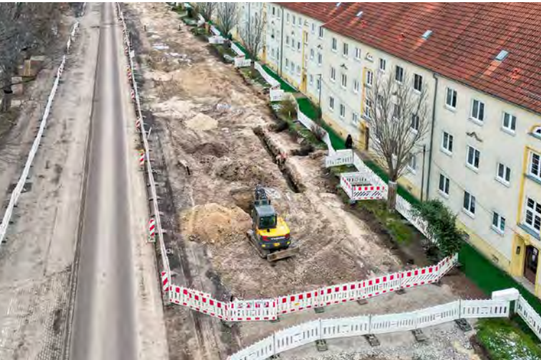
Bild: © Stadwerke Halle GmbH/ESMERO
