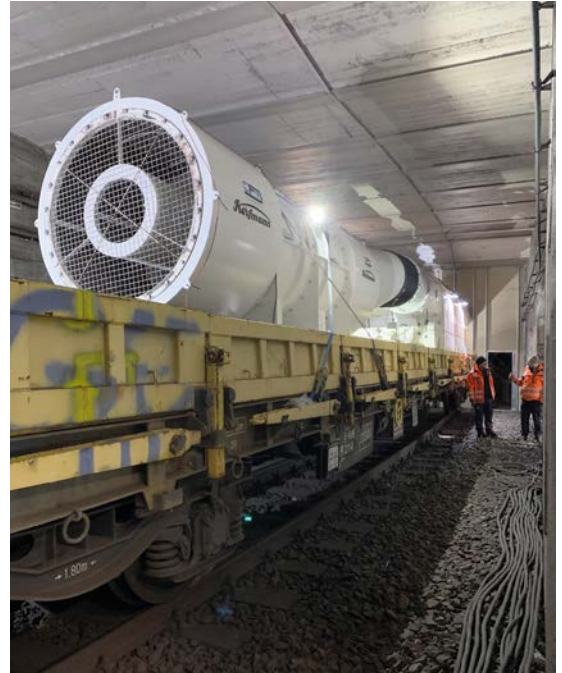
Die CFT-Trockenentstaubungsanlage mit Axialventilator zur Reinigung staubhaltiger Abwetter aus dem Baufeld
