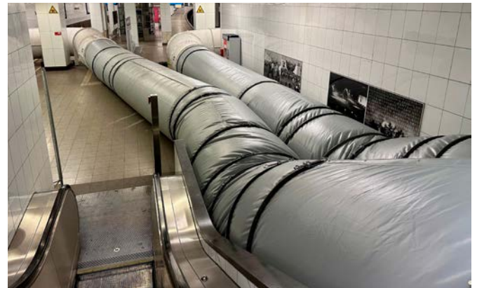
Im Bahnhof Potsdamer Platz sorgten Lutten (luftdichte Röhren) für eine aktive Entlüftung (Abwetter) über einen Kamin ins Freie.
