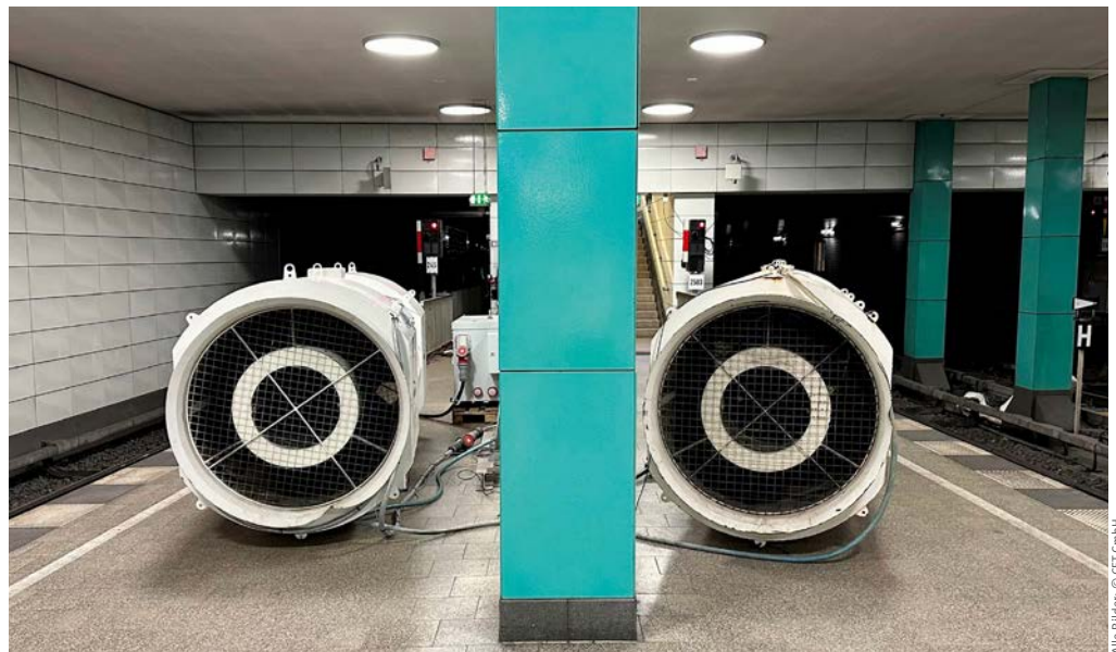
Axialventilatoren auf dem Bahnsteig des Anhalter Bahnhofs: Dieser Tunnel wurde durch reinen Luftaustausch bewettert.
