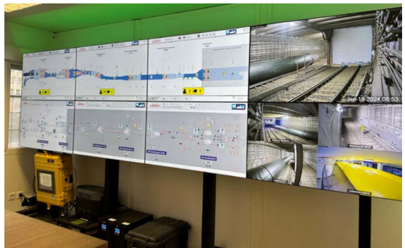
Zentraler Leitstand zur Anzeige aller Messdaten, zur Steuerung der Ventilatoren im Baufeld sowie zur Darstellung der Personenortung
