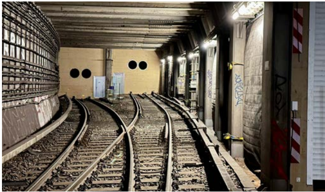
Für eine gezielte Erfassung der Feinstäube wurden die staubigen Arbeitsbereiche durch Wetterwände vom weiteren Tunnel abgetrennt.
