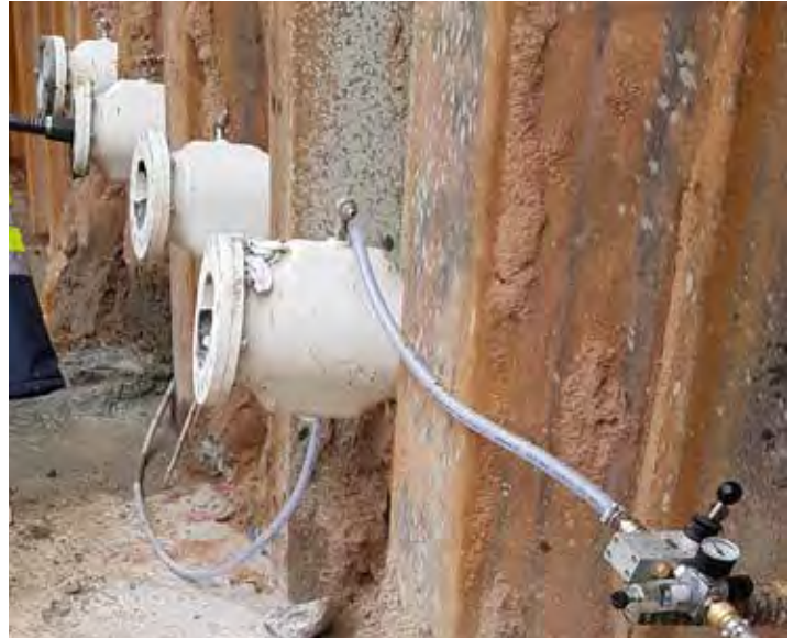
Abb. 4 · Die vier eingesetzten Preventer. Der linke ist bereits verschlossen.
