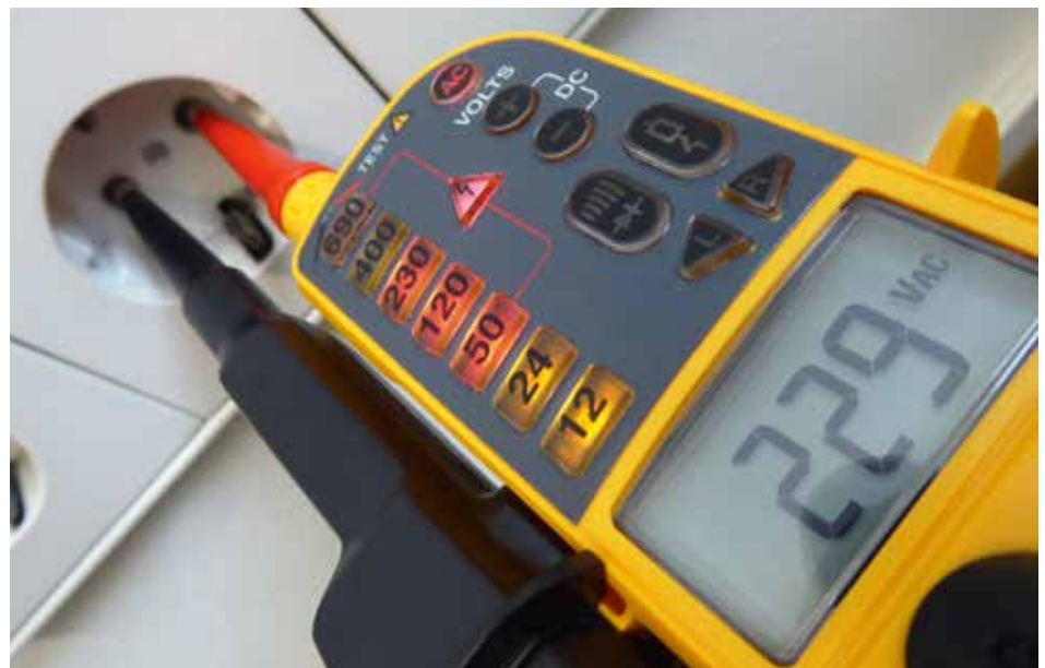
Elektrische Arbeiten, z. B. das Prüfen oder Messen, erfolgen nur durch Elektrofachkräfte.
