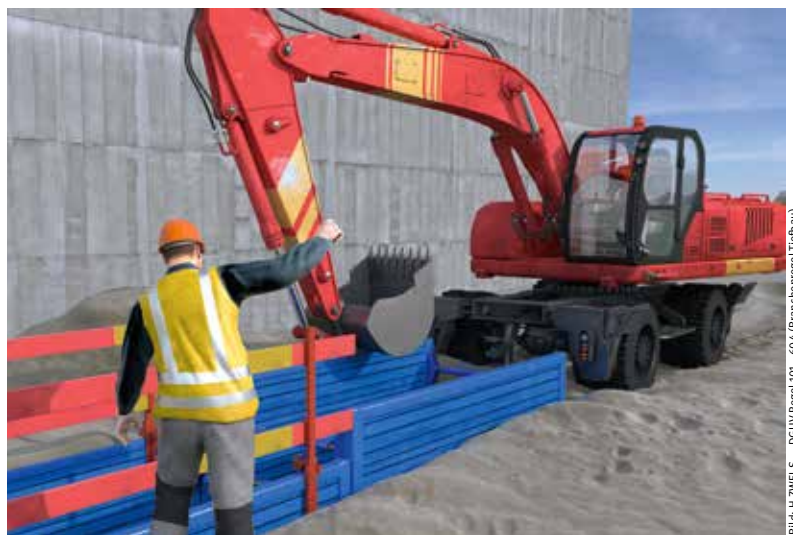
Abb. 5 · Graben ohne Absturzsicherung im Arbeitsbereich des Baggers während des Grabenaushubs
