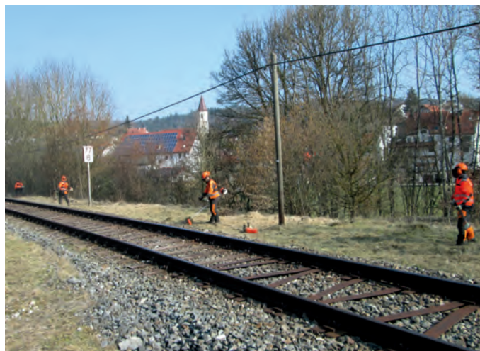
Abb. 3: Vegetationsarbeiten; Grenze zum Gleisbereich nicht erkennbar; kein Schutzstreifen (Foto: BG BAU, Hauff)
