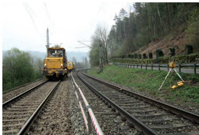
Abb. 2: ATWS-Zentrale (rechts), die über Funk die Warnsignalgeber auf den Maschinen (hier SSP und GSM) und Materialwagen im zugeordneten Warnbereich ansteuert
