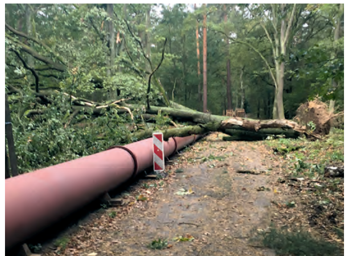
Abb. 5: Sturm und anhaltende Regenfälle erschwerten nicht nur die Arbeiten bei der Sanierungsmaßnahme, sondern gefährdeten auch die oberirdisch verlegte Bypassleitung
