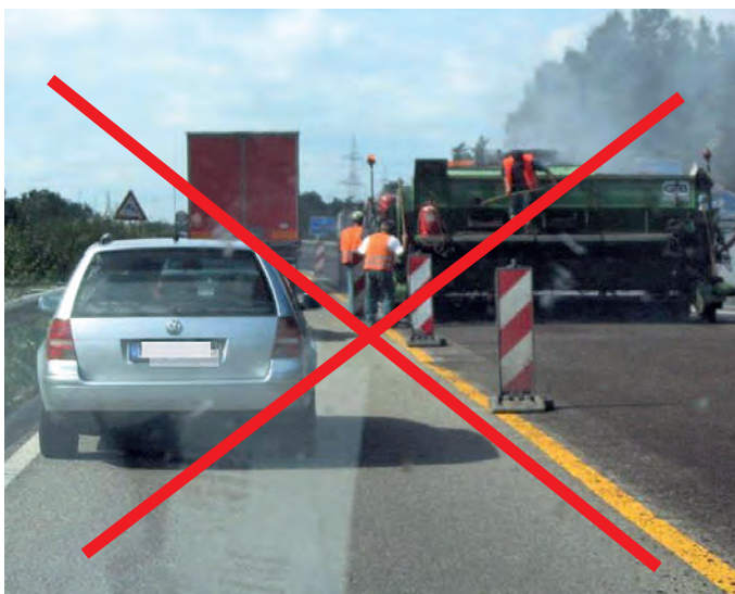
Abb. 1: RSA-95 nicht eingehalten, Arbeitsstättenverordnung nicht eingehalten – Konsequenz: nicht akzeptable Arbeitsbedingungen in Verbindung mit erhöhten Gesundheits- und Unfallrisiken
