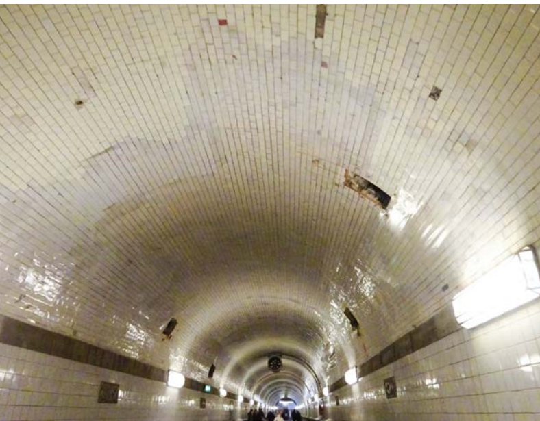
Die Fliesenschäden in der Weströhre vor Beginn der Sanierungsarbeiten
