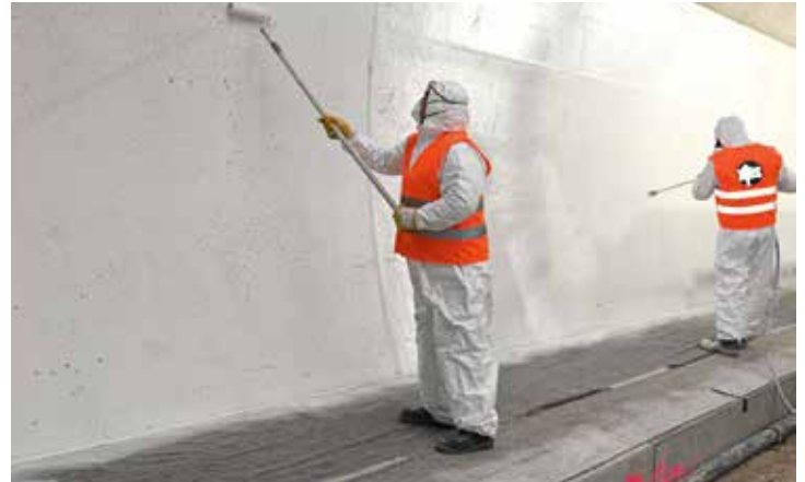
Lunker im Sichtbeton müssen im Zweifel in einem zweiten Arbeitsgang nachbeschichtet werden.
