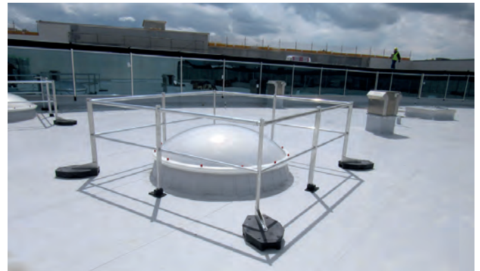
Abb. 10: Lichtkuppel mit Seitenschutz (Foto: Kee Safety GmbH)
