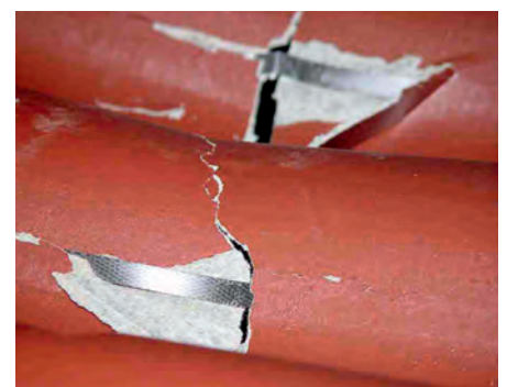
Abb. 2: Gebrochene Faserzementplatte mit Armierung (Foto: BG BAU/Otto)
