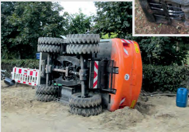
Der umgekippte Mobilbagger (Foto: BG BAU)
