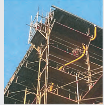
Abb. 4: Zugang nach dem Unfall, Wetterschutzdach plettac Modul 75
