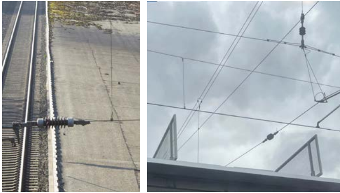
Bahnsteigdach mit offenem Isolator und Bahnsteigdach mit Hindernis
