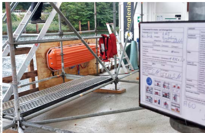
Sicherheitseinrichtungen an einem Pfeiler-Fundament im Borgstedter See: Schleifkorbtrage, davor Rettungswesten (li.) und Erste-Hilfe-Station (Hintergrund)
