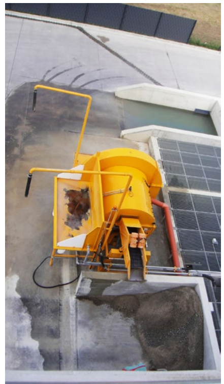
Abb. 28 Recyclinganlage mit abgedecktem Becken
