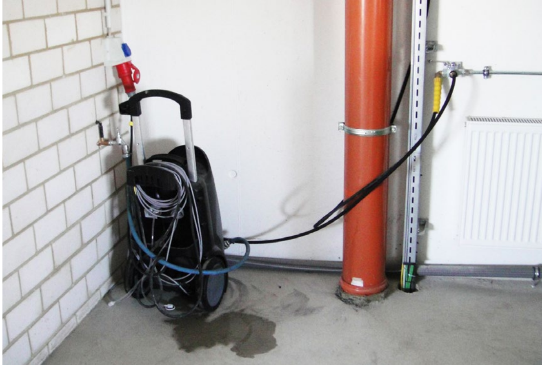
Abb. 26 Zentral untergebrachter Hochdruckreiniger für Reinigungsarbeiten mit Verteilleitung
