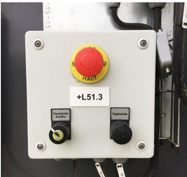
Abb. 18 Vor-Ort-Steuerung um Becher des Becherwerkes zu positionieren
