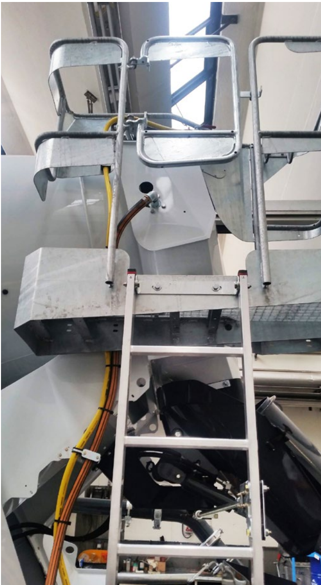
Abb. 44 klappbare Absturzsicherung am Aufstieg
