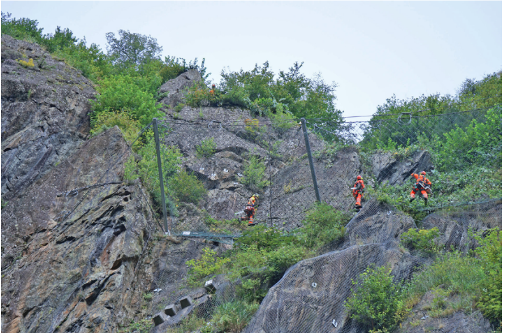
Abb. 11 Auffangnetz für Personen und Material
