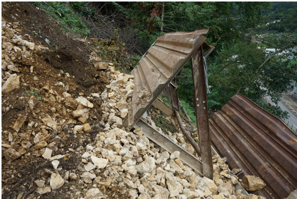
Abb. 10 Schutzwand zum Schutz vor herabfallenden Steinen und Werkzeugen
