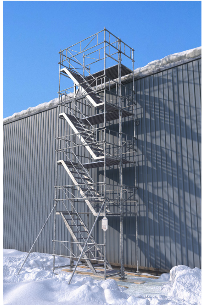
Abb. 12 Beispiel für einen temporär erstellten Treppenturm
