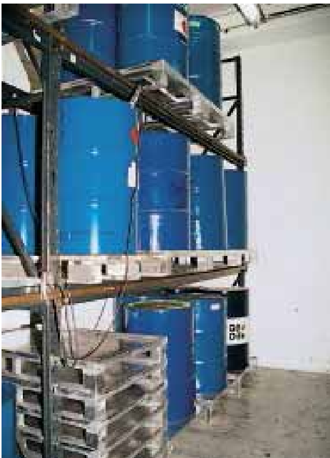
Abb. 23 Regale im Lacklager mit Potentialausgleich
