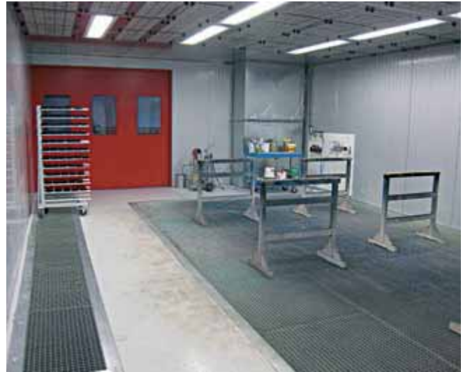
Abb. 29 Lackierraum, links Abluftanlage für frisch beschichtete Teile
