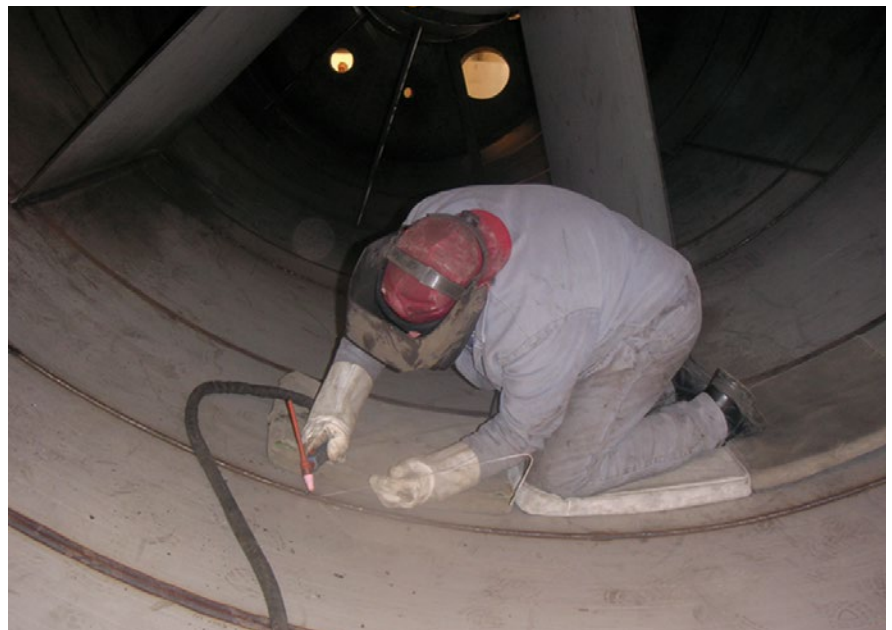
Abb. 5-4 Geschützt durch isolierende Unterlage
