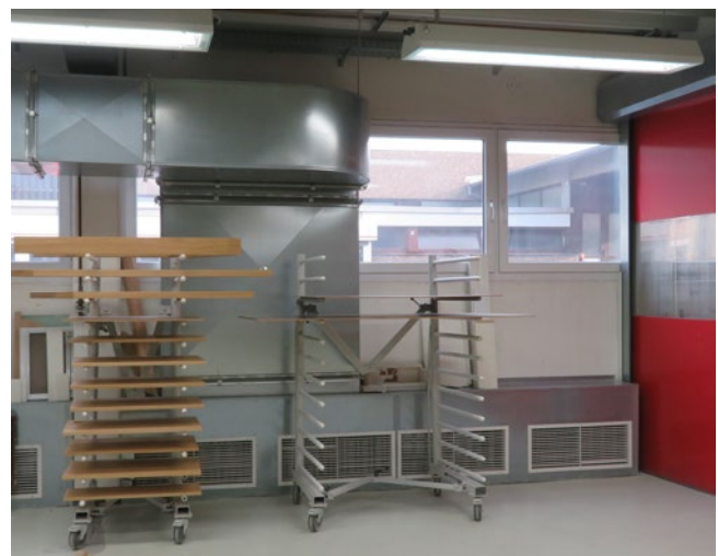
Abb. 27 Bodennahe Absaugung an Hordenwagen
