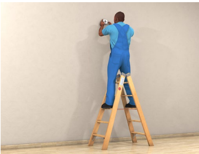
Abb. 56 Sicherer Stand auf einer beidseitig begehbaren Stufenstehtleiter
