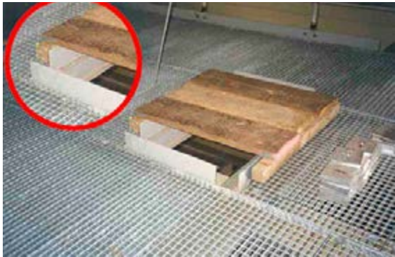
Abb. 4-15 Nicht vollständig geschlossene Bühnenöffnung
