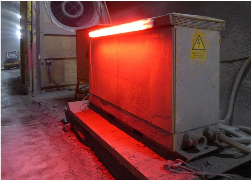
Abb. 6 Trafostation als Übergabepunkt
