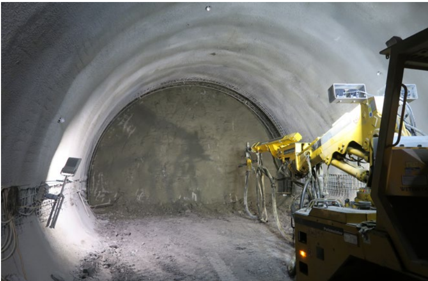
Abb. 17 Beleuchtung im Tunnel
