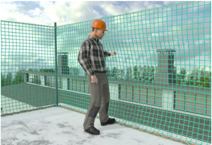
Abb. 22 Randsicherung auf der Dachfläche
