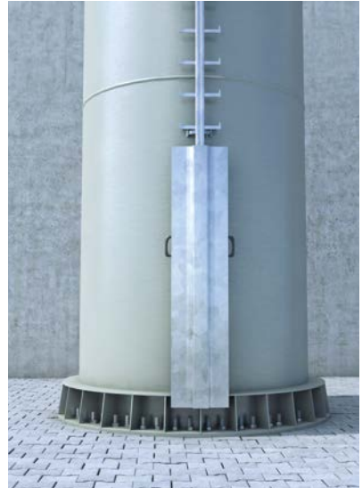
Abb. 5 Steigleiter bis zum Boden geführt und gegen unbefugte Benutzung gesichert
