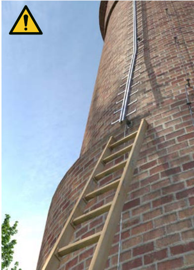
Abb. 4 Unsichere Zugangssituation bei Steigleitern am Schornstein
