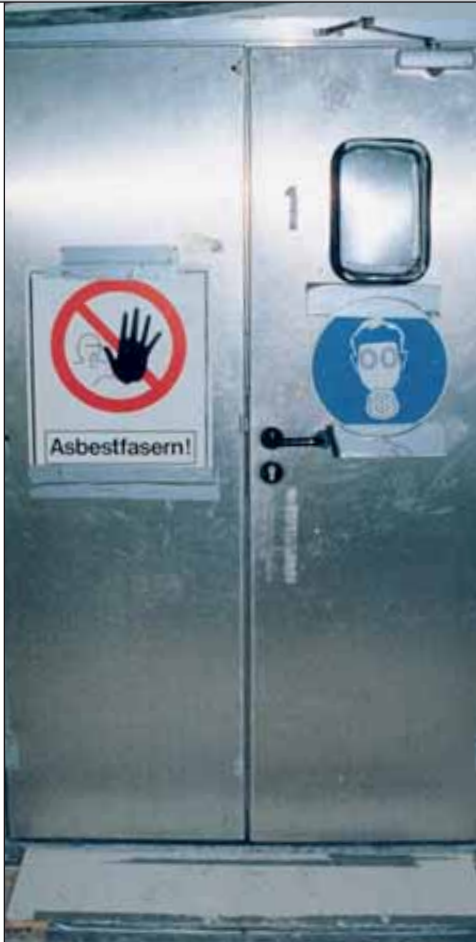
Materialschleuse, zwangsverriegelt, Kammer 1
