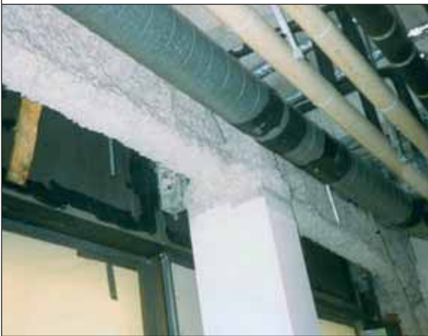
Träger mit Spritzasbest, Stützenverkleidung mit Promasbestplatten
