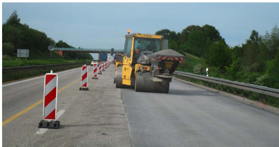
Walze im Hundegang Foto: Langer, BG BAU
