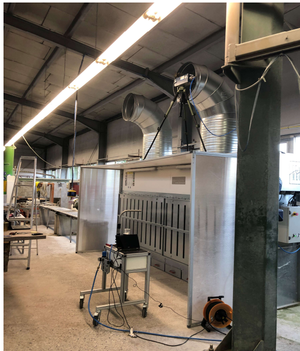
Bild 1: Umlenkung der gefilterten Luft mittels eines Rohrbogens aus Wickelfalzrohren
