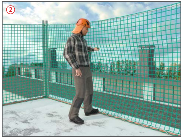
Randsicherung auf der Dachfläche
