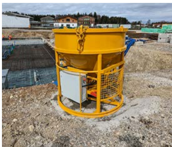
Betonsilo mit ferngesteuerter Öffnung
