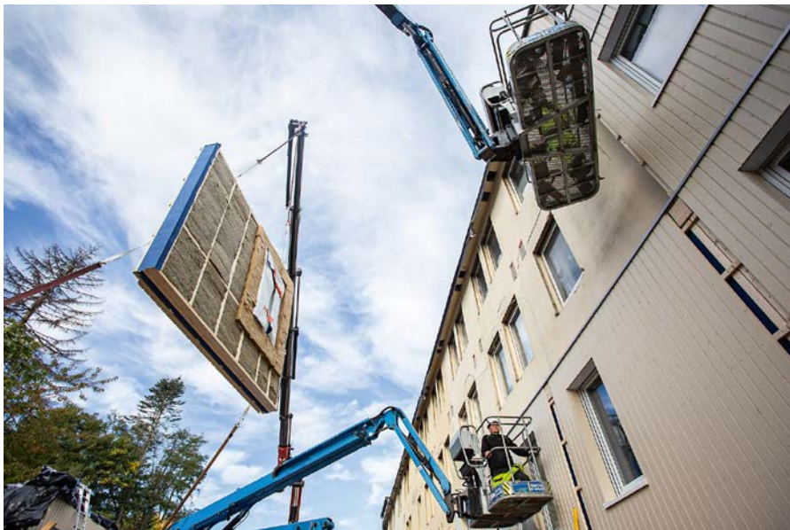
180 vorgefertigte Fassadenelemente inklusive Dämmung, Fenstern und Rollläden sowie Lüftung wurden von Renowate in der Zeppelinstraße verbaut.
